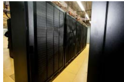
Der Hochleistungsrechner verfügt über eine energiesparende und vielseitig nutzbare Architektur. Bild: Jan Ehlers
